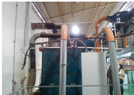
מפעל אוה, מפרץ חיפה: מתקן לטיפול בגזי הפליטה
